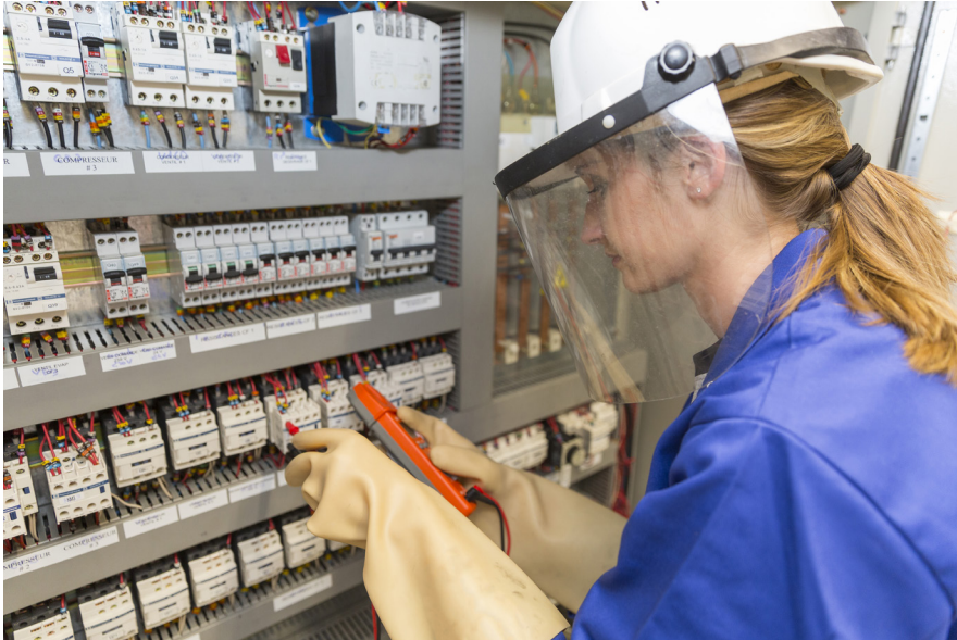
Service, måling og kontroll i spenningsatt styretavle
