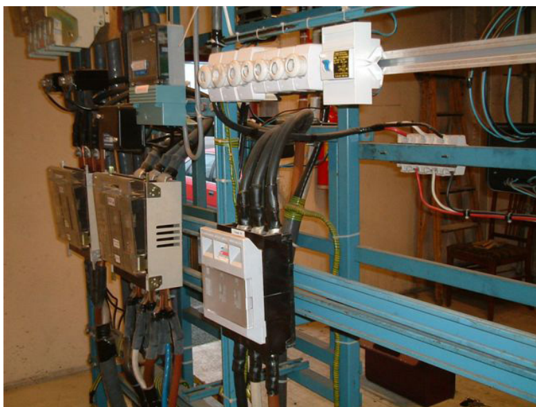
Eldre tavle med sikringskillebryter
