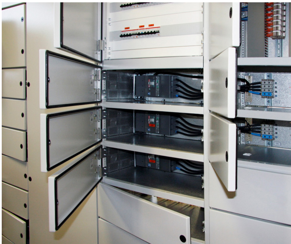
Fordelingstavle i utførelse form 4b
